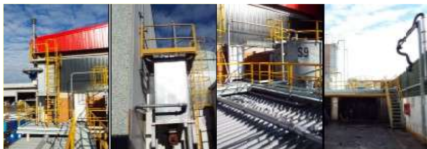
Fig.4 Gli impianti di aspirazione e abbattimento
